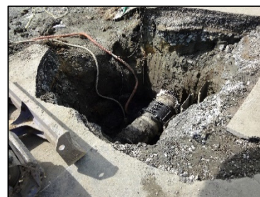
破損した配水管 (山武市和田地先)
