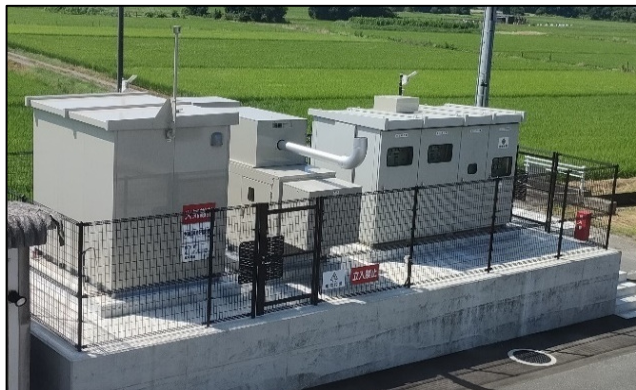
事務局庁舎 非常用自家発電設備（令和5年度）
