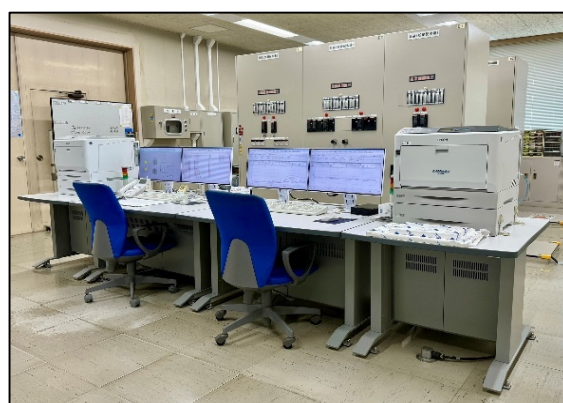
東金配水場遠方監視制御設備更新 (令和5年度)
