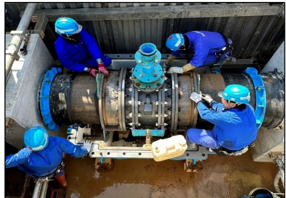
東金配水場（令和6年度）
