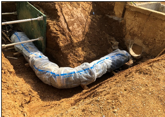
松尾配水場（令和2年度）
